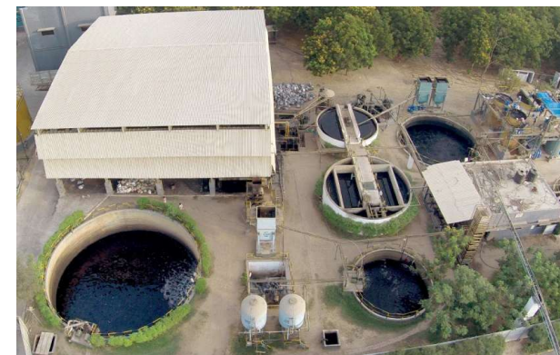
Effluent Treatment Plant (ETP)
